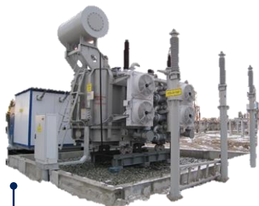
Электромагнитная часть УШРТ 25000/110 УХЛ 1
